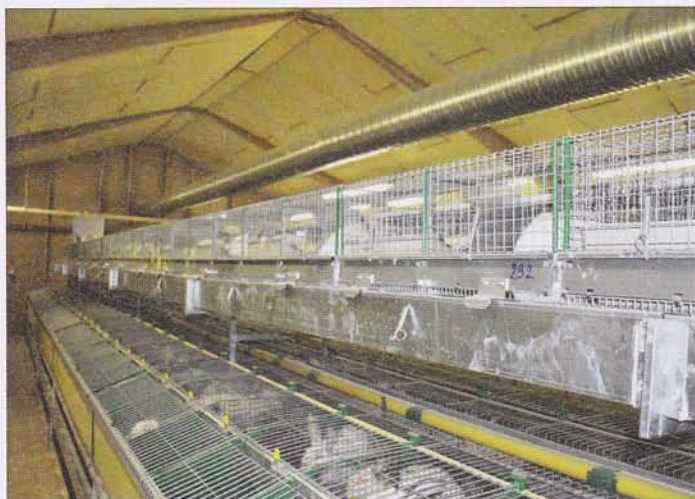
▲ Trois rangées de cages C298 (« Kit Etage C298 étages », Chabeauti) ont été installées dans la petite salle et une rangée dans la grande.
